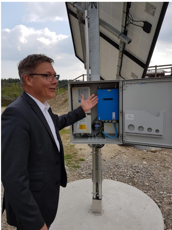
Regierungsrat und Baudirektor Roland Fürst schaltet die Solarpumpe von der Firma ERSAP Energie AG aus Lohn-Ammannsegg ein.
